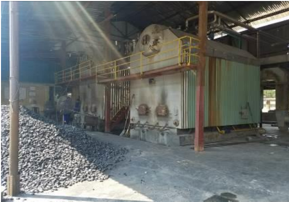
Hình ảnh lò hơi của công ty
